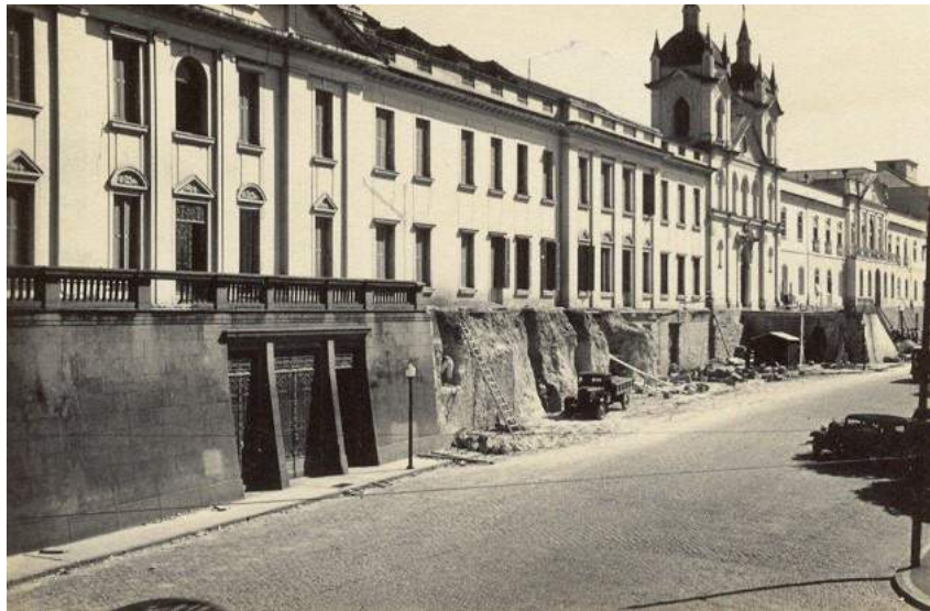
1940. Demolição da escadaria de acesso ao Hospital São Francisco para alargamento da rua. Acervo do CHC. Doação de Sérgio da Costa Franco.
